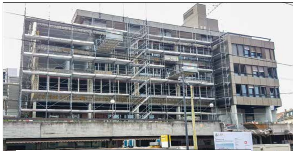
Auch die Sanierungs- und Umbauarbeiten am neuen Standort in Binningen schreiten voran.
